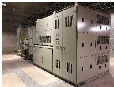
電力吸収装置
