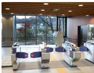
東西線自動出札設備
