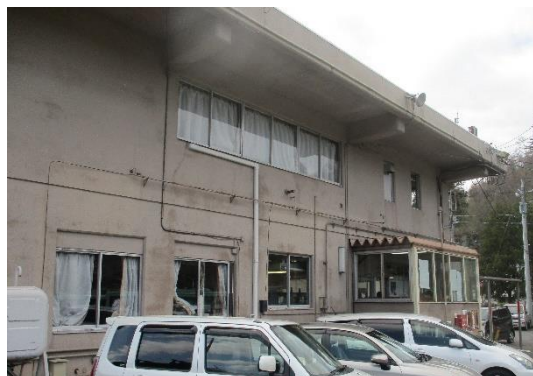
老朽化が進む川内営業所
